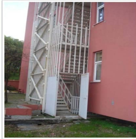
Yangın Merdivenlerinin Çıkış Kapısının Kilitli Olmaması
